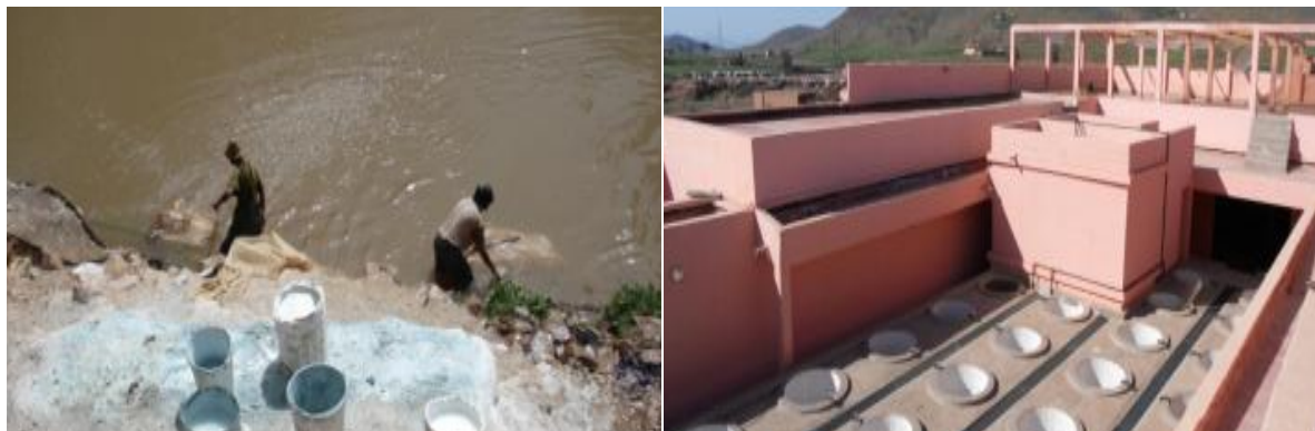
Figure 12 : Mise à niveau d'une tannerie traditionnelle
