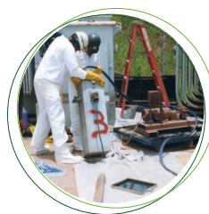
Gestion sécurisée des appareils à « PCB »
