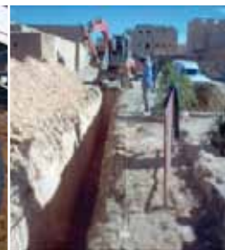
Réseau des eaux usées à Rissani
