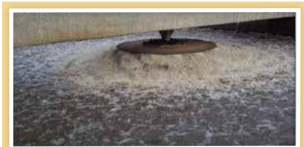
PHOTO 9 : Turbine de surface à vitesse lente (Immersion insuffisante)
