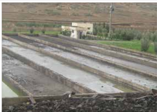
Curage du bassin et refoulement des boues liquides vers lit de séchage
