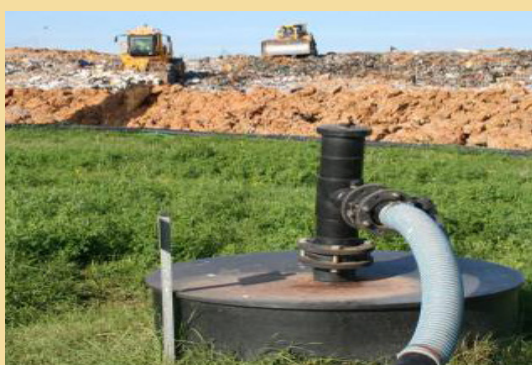
Tête de puits étanche raccordé au réseau de collecte du biogaz
