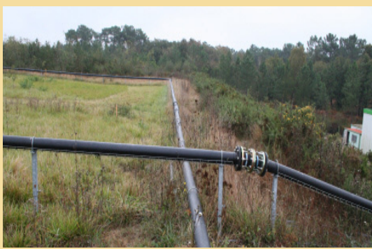
Réseau de collecte du biogaz reliant les puits à la torchère
