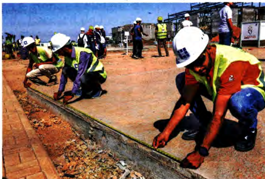
Depuis le mercredi 21 août dernier, des étudiants se penchent sur la phase de construction et d'assemblage de maisons intelligentes et durables. Ils ont mis plus d'un an à les concevoir. Leur défi est de les finaliser en seulement 3 semaines (Ph. Iresen)
